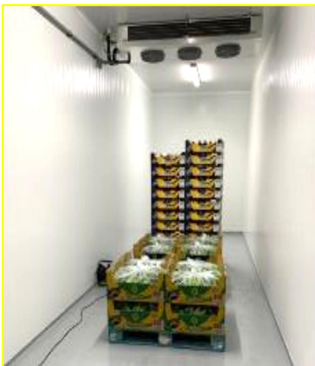
Figura 3. Palés de plátanos tratados en cámara de conservación.
